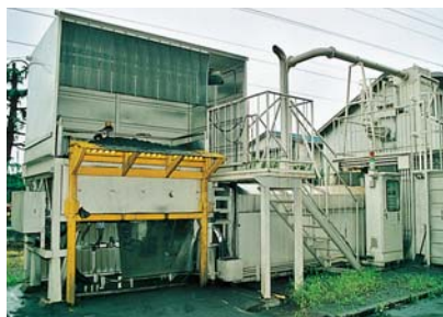
鋳物廃砂乾燥装置
