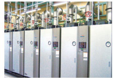
小型貫流ボイラー（鴻巣工場）
